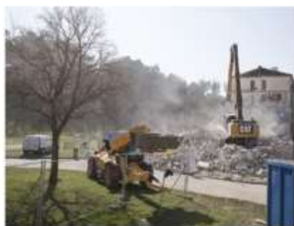
Parmi les chantiers concernés par les clauses sociales : la démolition de l'Étrier de voies vertes, d'espaces verts et d'activités de loisirs.
