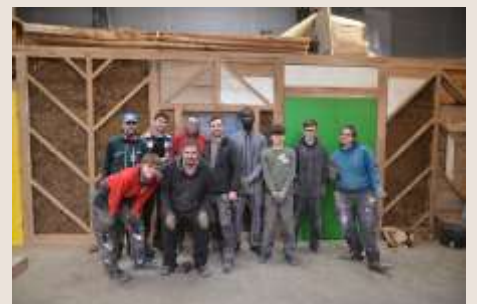
Remplissage terre paille de cloisons, ateliers de l'association Comme un établi - Rennes (35)
